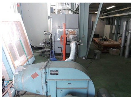
背面（オリフィス、補助送風機側）
