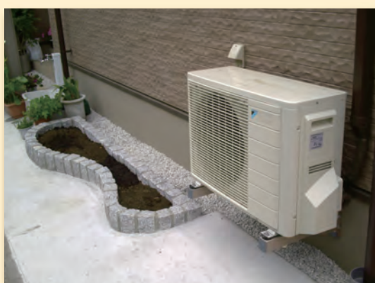
室外機設置状況
