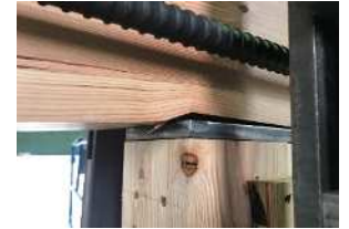
写真2 補強プレートのめり込み
