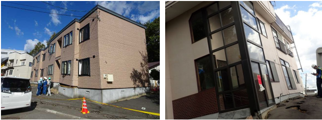
写真1 地盤変状により基礎・上部構造ともに損傷した共同住宅と専用住宅
