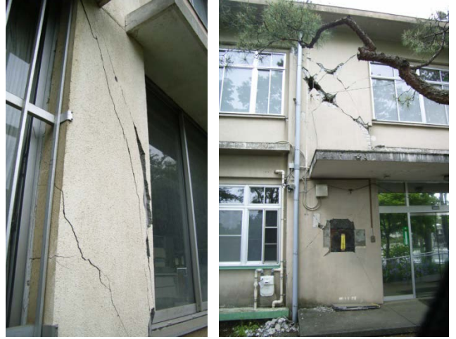
写真-4 隣接 RC 造建物 (No. 7) の被害
