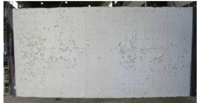
写真1 No.1(無補修)実験後の状況
