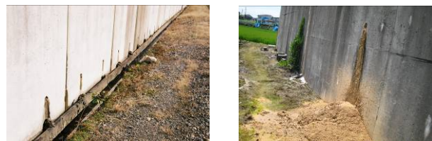
写真3 被害擁壁水抜き孔からの土砂流出 (左：2004年新潟県中越地震 右：2007年新潟県中越沖地震)
