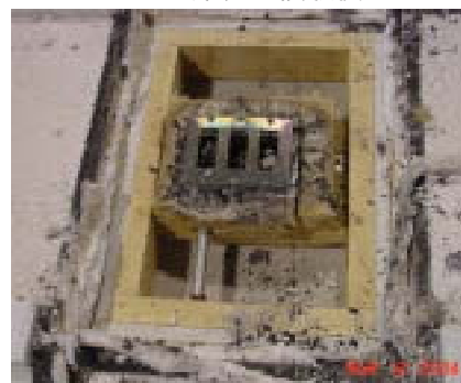
写真3 コンセントボックス・ユニットの状況
