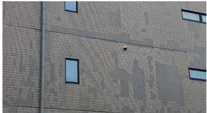
外装タイル研りの騒音 色違いによる意匠性の低下が減少
