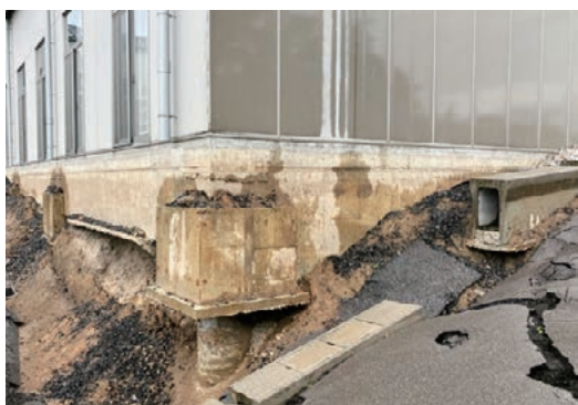
写真4 F 中学校施設周囲の地盤変状の様子
