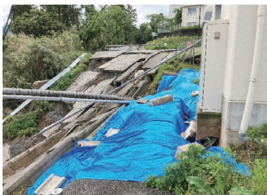
写真2 G団地付近の斜面崩壊
