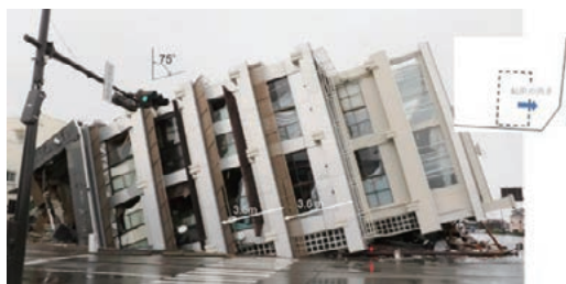
写真1 転倒したA建物（南側から撮影） 1)
