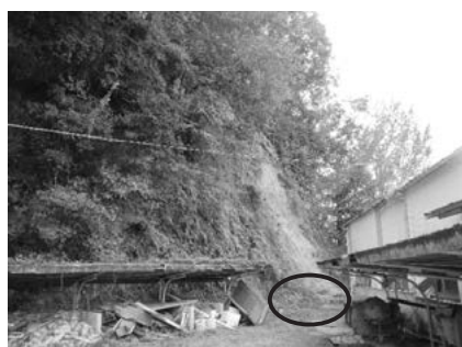
写真2 崖地から崩落し堆積したシラスの状況 （第一工業大学建築実習棟隣接の崖）
