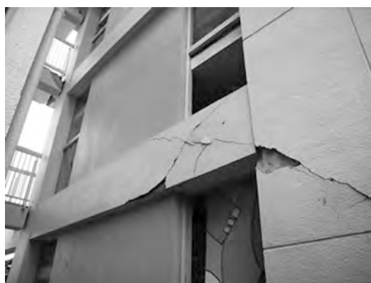
写真2 セン断破壊したRC 造梁と壁
