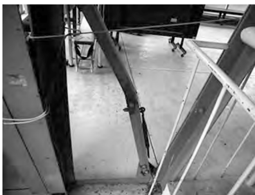
写真3 座屈したS 造トラス形式の柱
