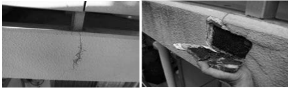
写真1 コンクリートのひび割れ、モルタル・タイルの剥がれ
