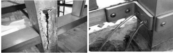
写真2 支柱の腐食、支柱内の雨水の滞水
