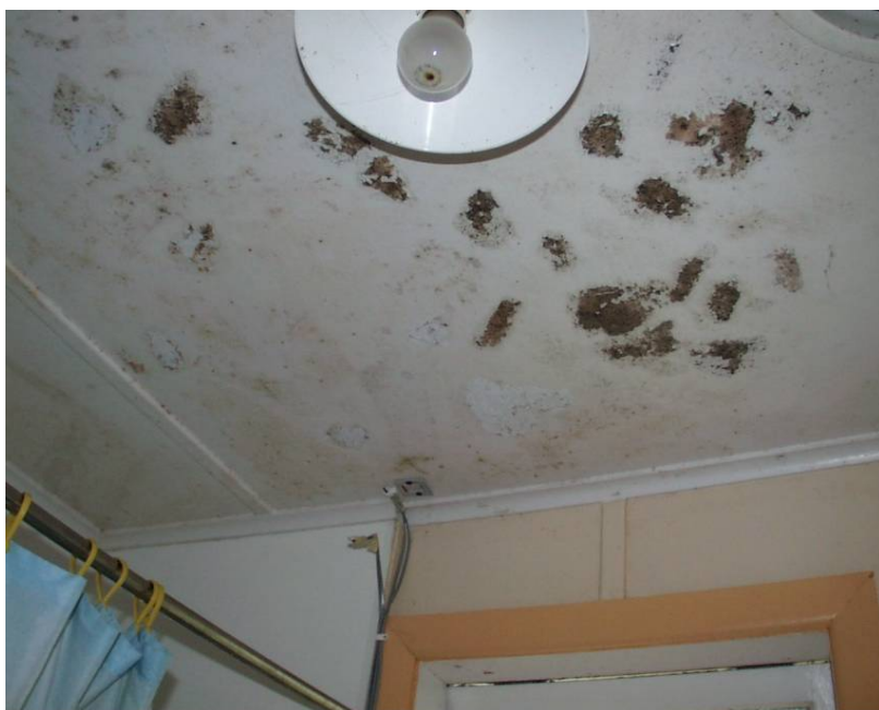
湿気が多い住宅の天井のカビ
