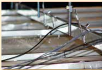
天井破壊：クリップ外れ
