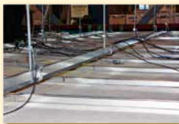
天井破壊：クリップ外れ
