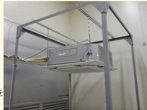
A室設置の 室外機
